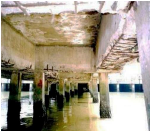
Hình 2. Ăn mòn kết cấu bê tông cốt thép tại các cảng biển ở Việt Nam
