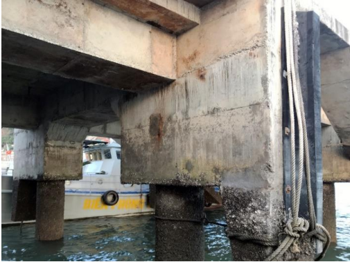
Hình 1. Ăn mòn kết cấu bê tông trong môi trường biển ở khu vực biển Hải Phòng
