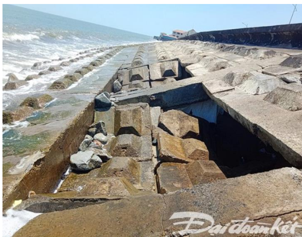
Hình 1. Một đoạn bờ kè bê tông bị sóng biển đánh sụp lún ở biển Cửa Đại (Nguồn Báo Đại đoàn kết)
